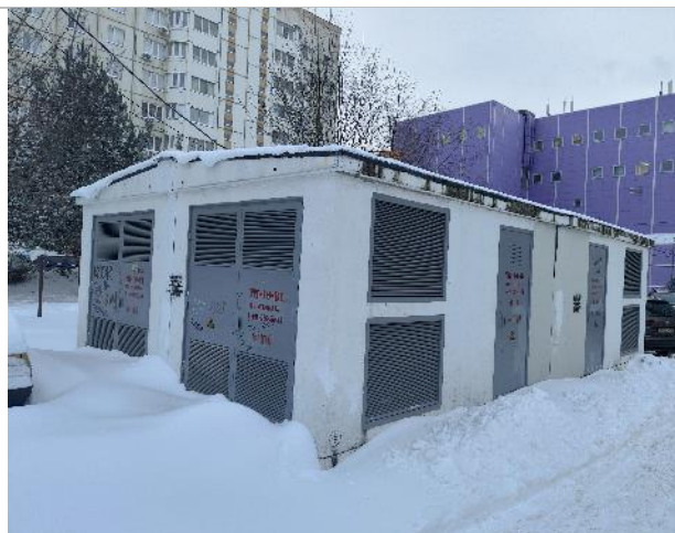
Фотография 138. Трансформаторная подстанция.
