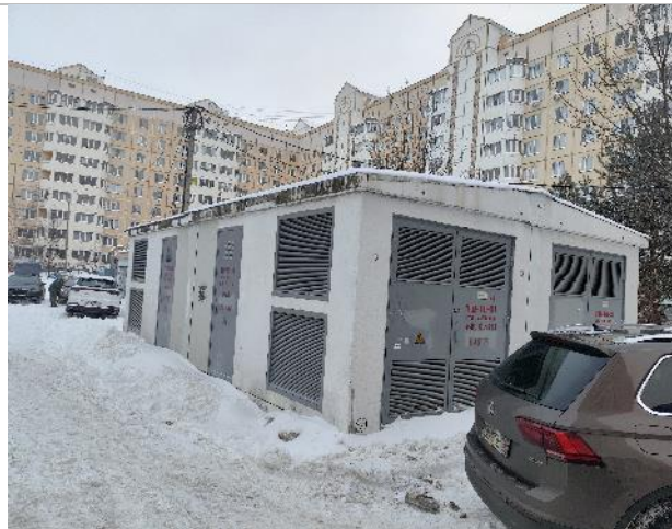
Фотография 135. Трансформаторная подстанция.
