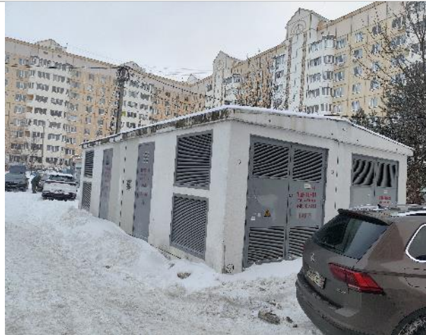
Фотография 3.7. Трансформаторная подстанция
