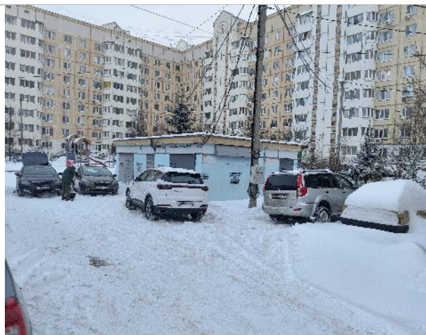
Фотография 137. Трансформаторная подстанция.
